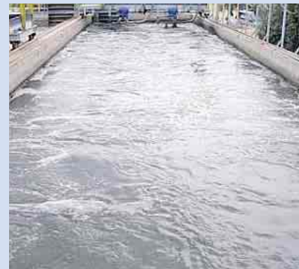
La vasca di ossidazione di un depuratore
